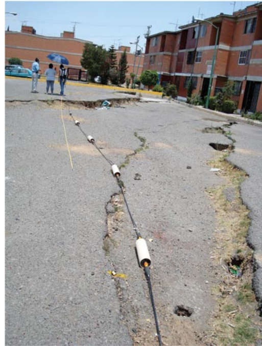
Aparición de fracturas y daño a los edificios de la Unidad Habitacional Tepozanes
