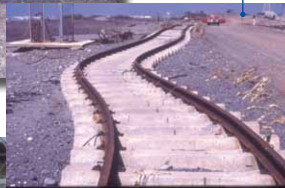
Vías del tren deformadas en la carretera de Lázaro Cárdenas
